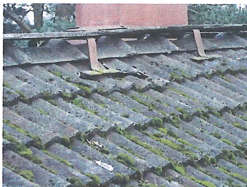
kattotiilet ja sillat uusittava
